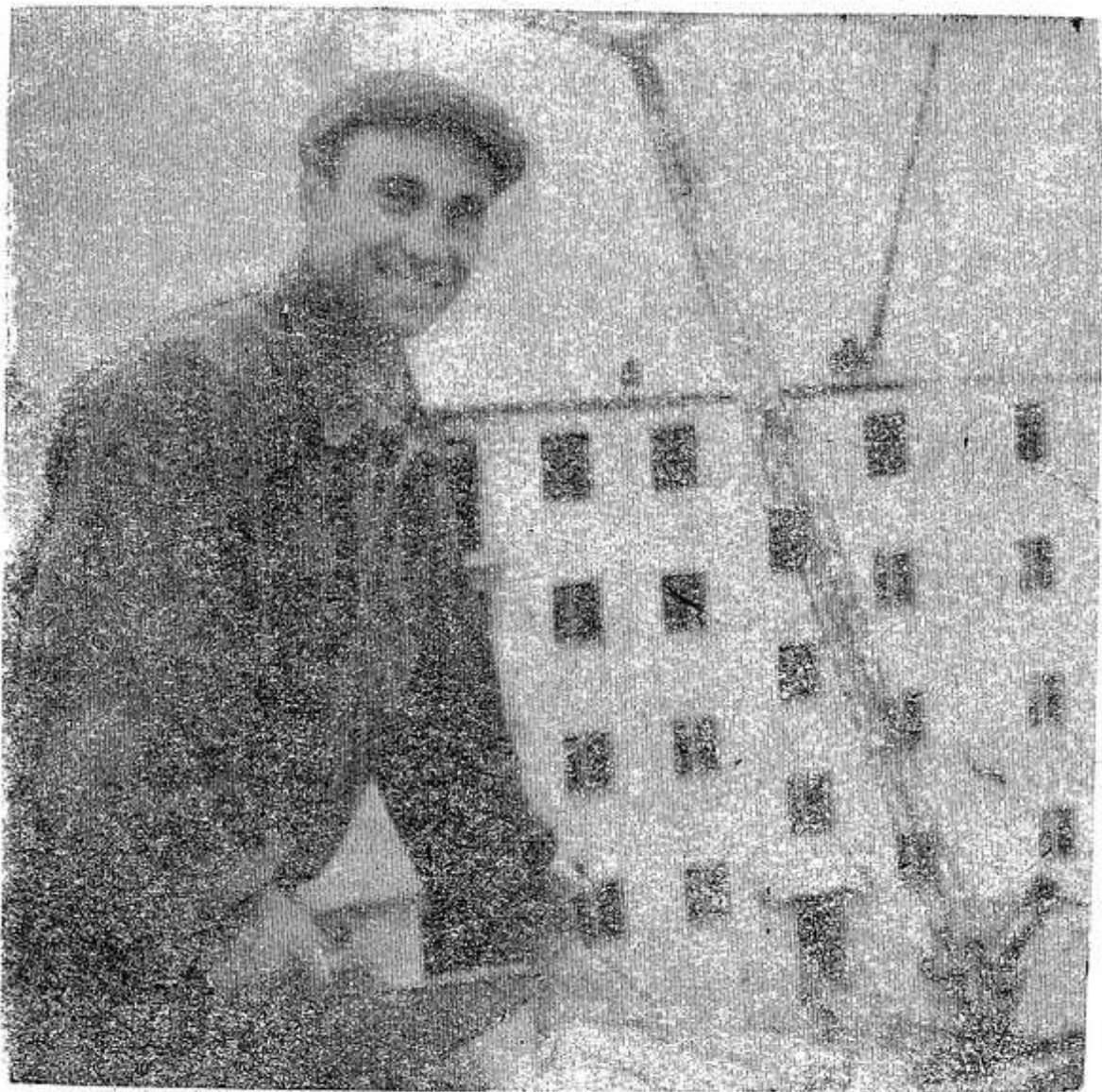
Это пока не дом, а коробка. Но пройдет немного времени, и строители отделают 48 прекрасных квартир.
