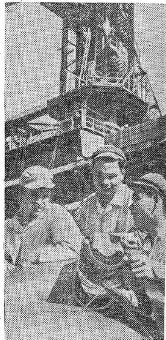
ДЕМОКРАТИЧЕСКАЯ РЕСПУБЛИКА ВЬЕТНАМ. Сварщики, работающие на строительстве металлургического комбината Тхай Нгуиен, досрочно закончили сварку корпуса пеллетодельителя доменной печи № 3.
